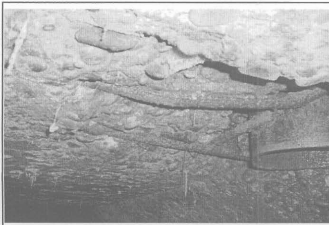
슬래브 배수구 주변 철근노출
