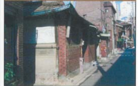
② 대상지내 노후·불량 건축물
